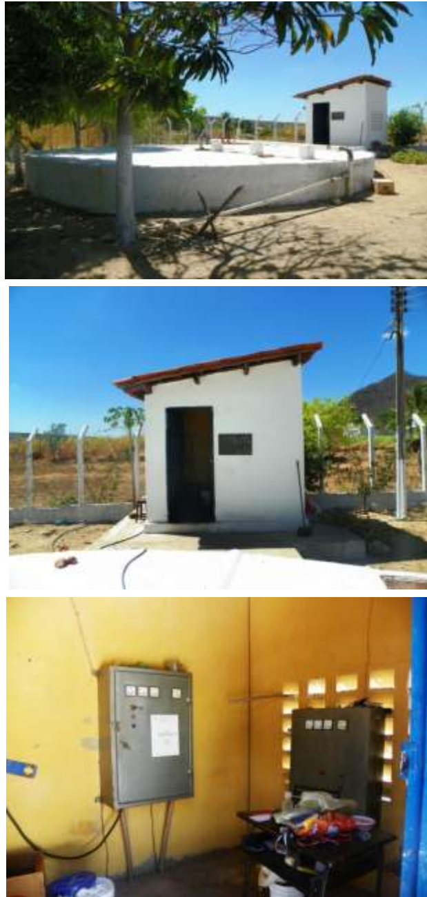
Figura 5.10 – Vista do poço amazonas (Q desconhecida), estação elevatória de água tratada (EEAT-01) e casa de comando que fazem parte do sistema do distrito de Ponta da Serra, município do Crato, de responsabilidade da SAAEC.
