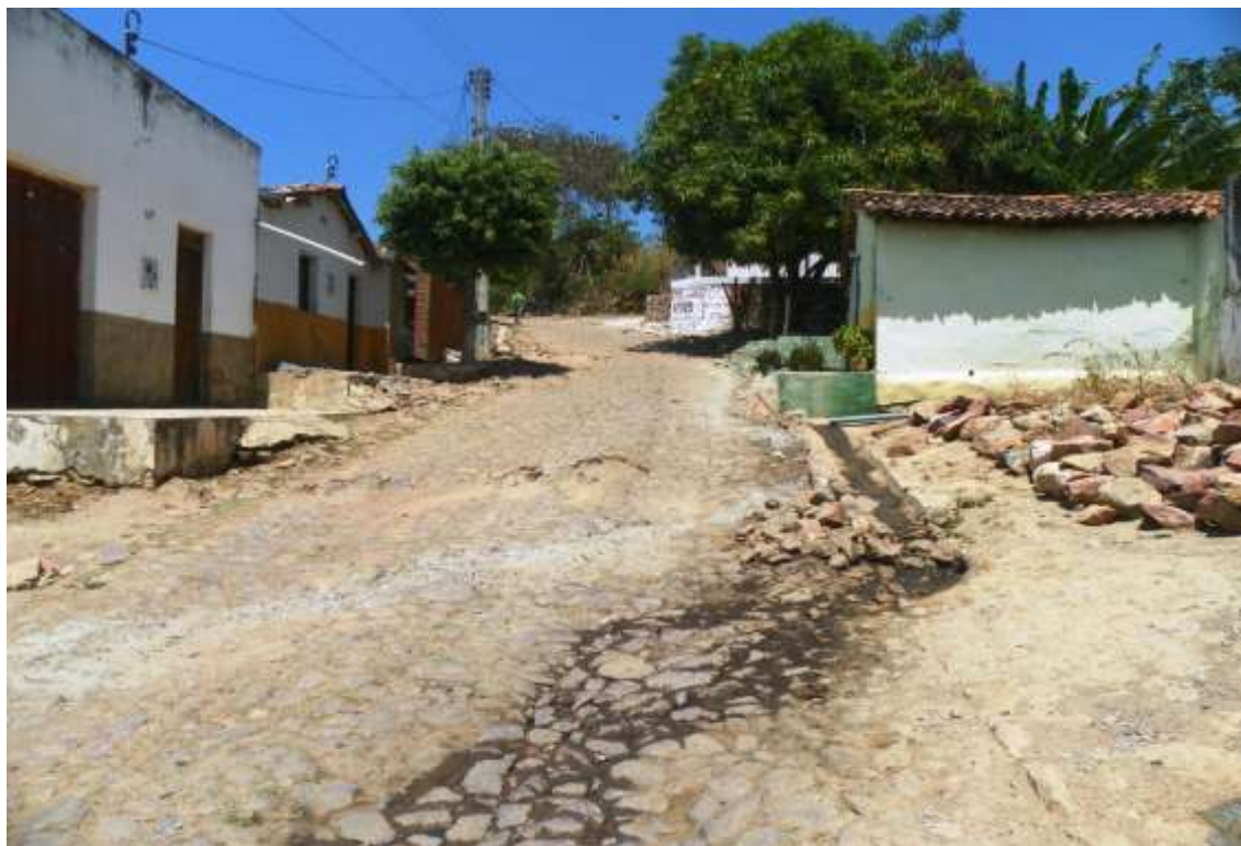
Figura 5.42 – Esgoto a céu aberto no distrito de Santa Fé – Rua Vicente Teles. Fonte: Consórcio DGH-Cariri (2012).
