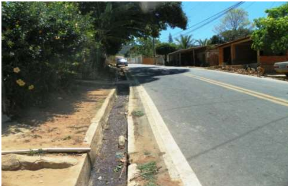
Figura 5.32 – Esgoto a céu aberto no distrito de Belmonte – Rua José Horácio Pequeno.
