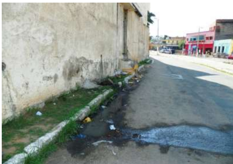
Figura 5.4 – Extravasamento no poço de visita localizado na Avenida José Alves de Figueiredo – Centro, sede do Crato. Fonte: Consórcio DGH-Cariri (2012).
