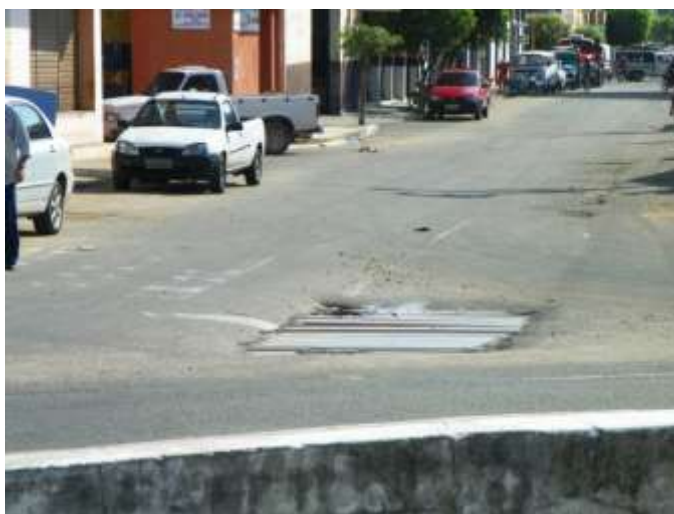
Figura 5.46 – Detalhe de boca de lobo instalada no centro da via.
